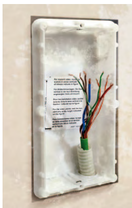
Remplacement de la platine de rue
