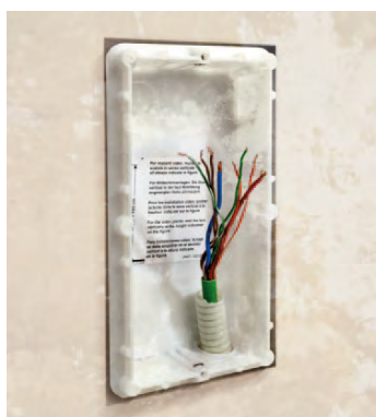
Remplacement de la platine de rue
