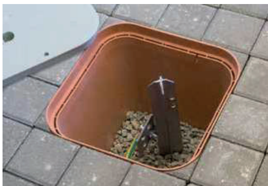
Installation avec piquet de mise à la terre
